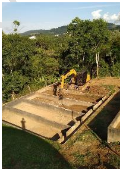
Figura 53 - Leito de secagem ETA de Taió
